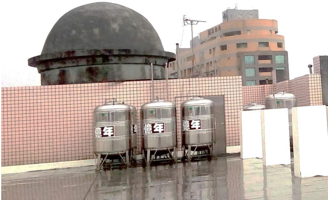
圖十一：本校頂樓水資源再利用儲存槽。
